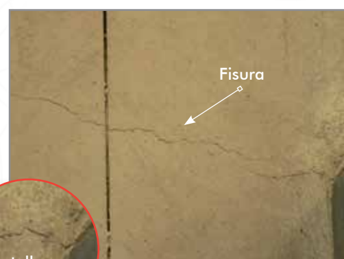
Fisura en esquina de pilar por serrado tardío
