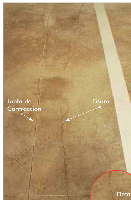
Fisura paralela a junta de contracción
